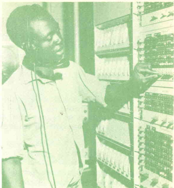
La stazione terminale di Kitwe è dotata di indicazioni di supervisione e di controlli per tutte le undici stazioni del sistema a microonde in funzione tra Lusaka e Kitwe nello stato dello Zambia.
